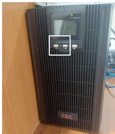
ภาพที่ 4.6 อุปกรณ์สำรองไฟ (UPS)
